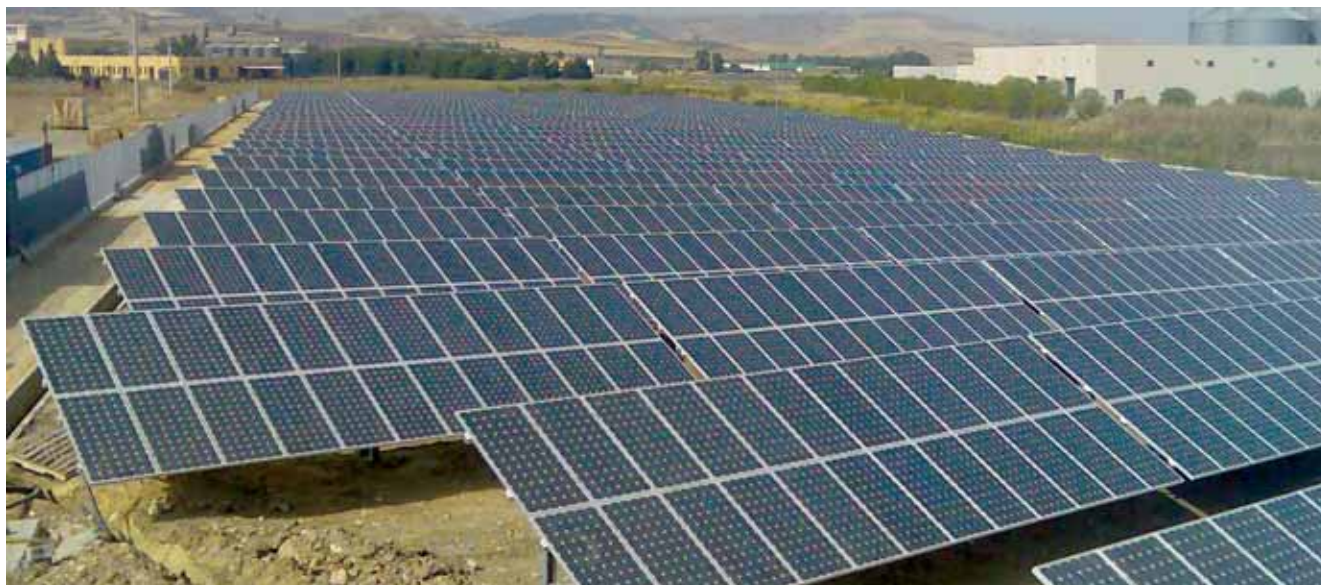
Un impianto fotovoltaico di Sorghia realizzato dal Gruppo Vona
