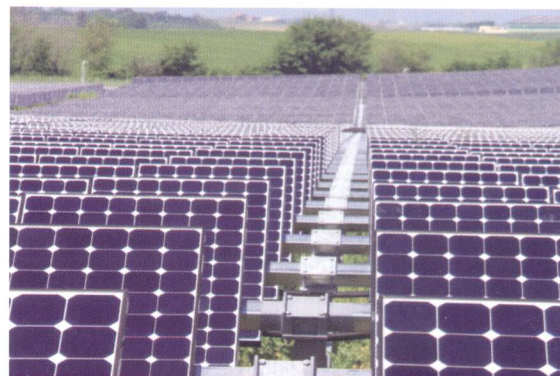
Uno degli impianti fotovoltaici realizzato dal Gruppo Vona
